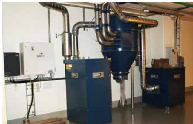
Dustcontrols suganläggning med DC Green System.
