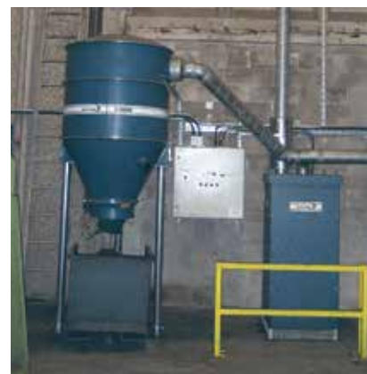
Varm luft från centralenheten pumpas tillbaka in i lokalerna under vintern för att spara på värme.
