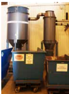
Den första centralsuganläggningen från 80-talet som har fungerat felfritt sedan dess.
