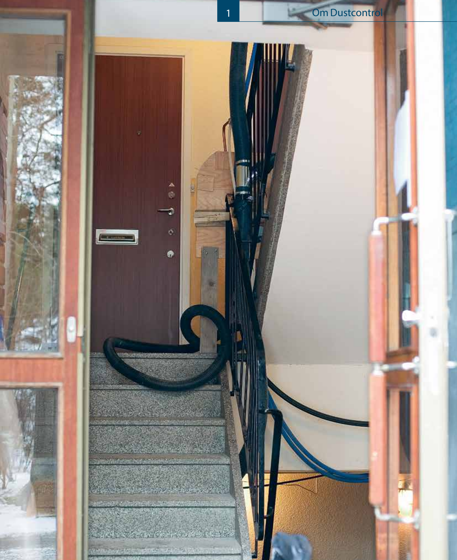
Ett temporärt rörsystem.
